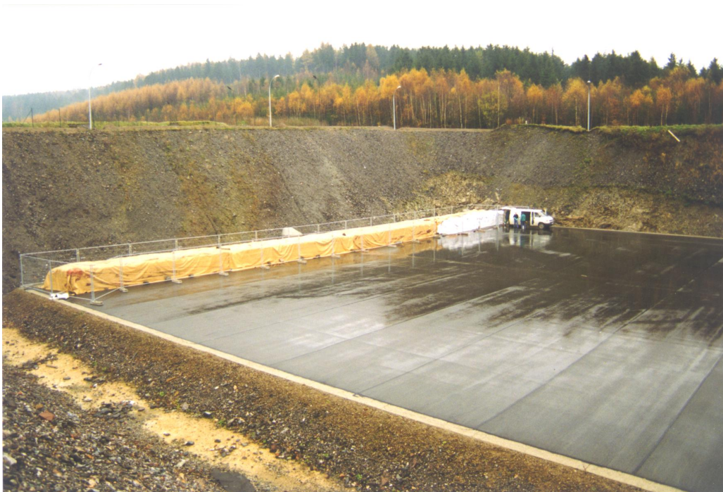
Abb. 1: Nach den Anforderungen der TA Abfall für eine Deponie DK III errichtete Ablagerungsfläche für WBA-Rückstände auf der Halde 371/I der Wismut GmbH
