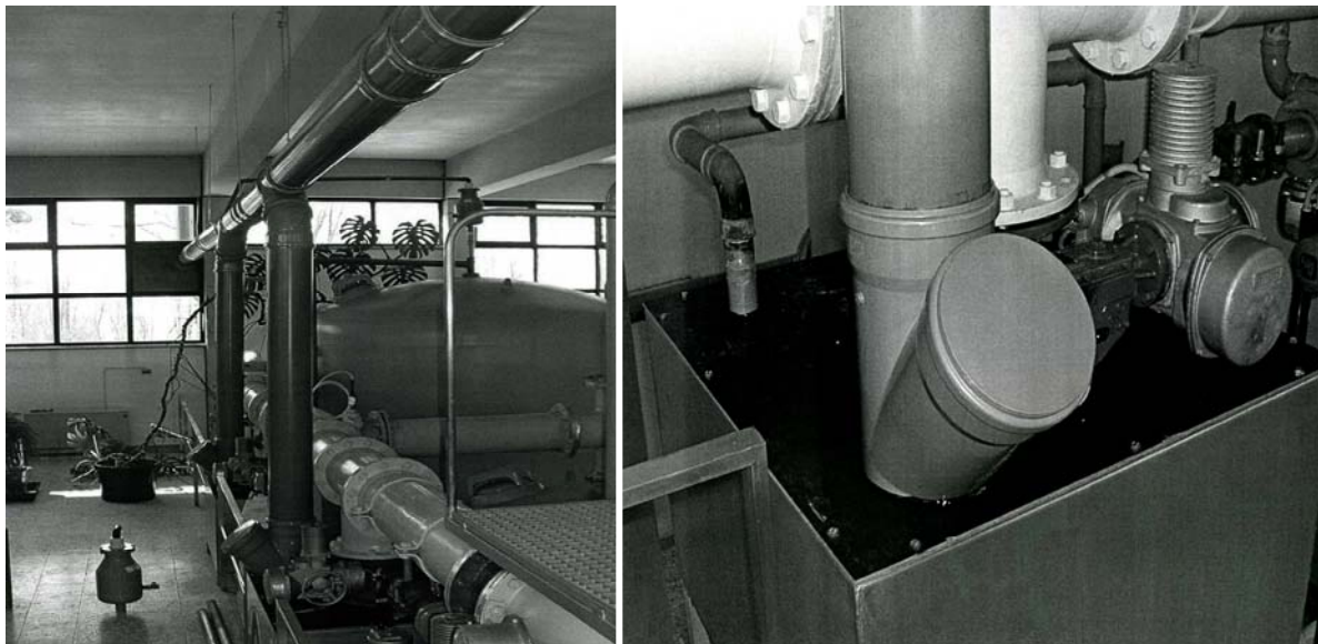
Abb. 7: links: Abtransport der Abluft durch Rohre direkt ins Freie; rechts: Abdeckung eines Spülkastens
