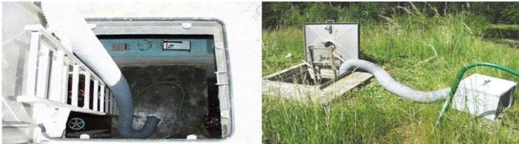
Abb. 4: Belüftung eines Quellschachts.
