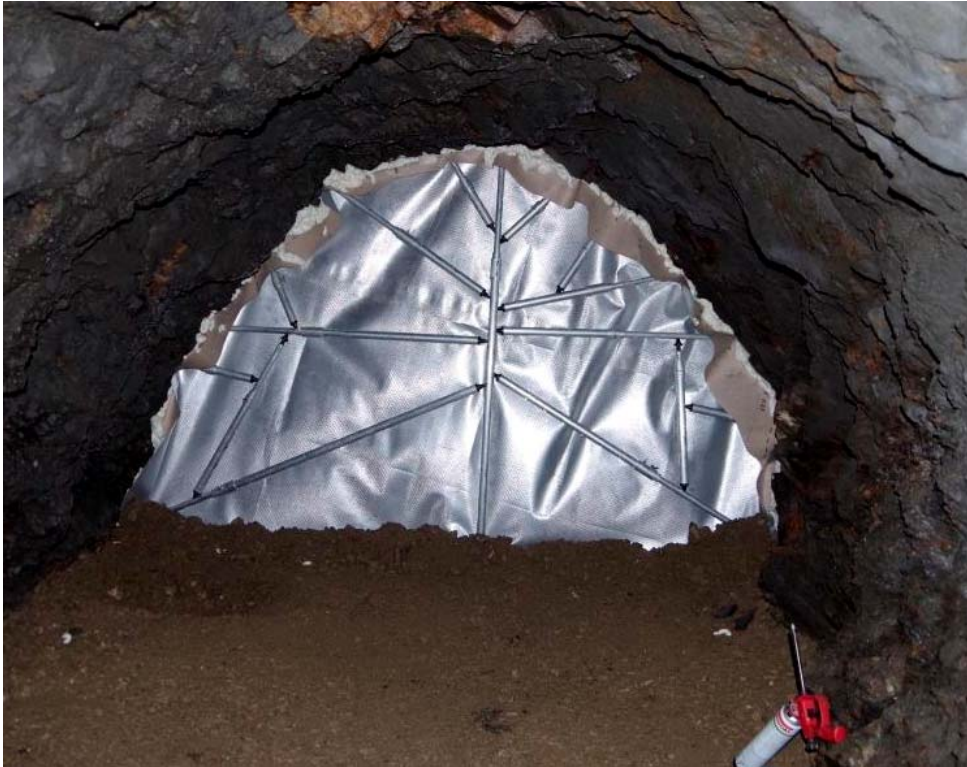
Abb. 2: Express-Wetterblenden-System aufgebaut in einem breiten Querschlag in Schneeberg
