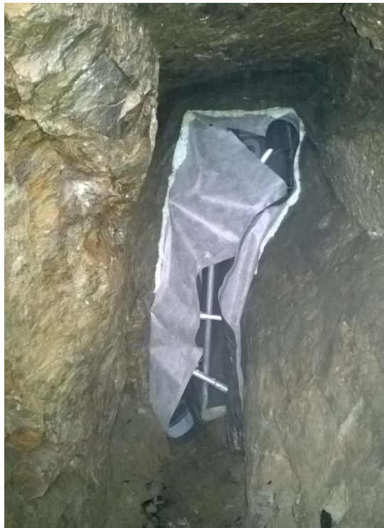
Abb. 3: Express-Wetterblenden-System aufgebaut in einem engen Stolln in Schneeberg
