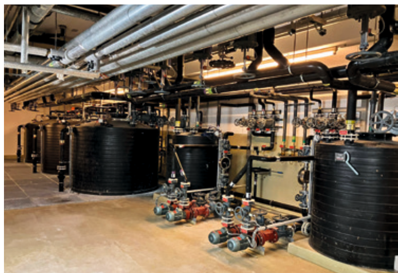
Abb. 3: Abklinganlage für radioaktiv kontaminierte Abwässer im Untergeschoss
