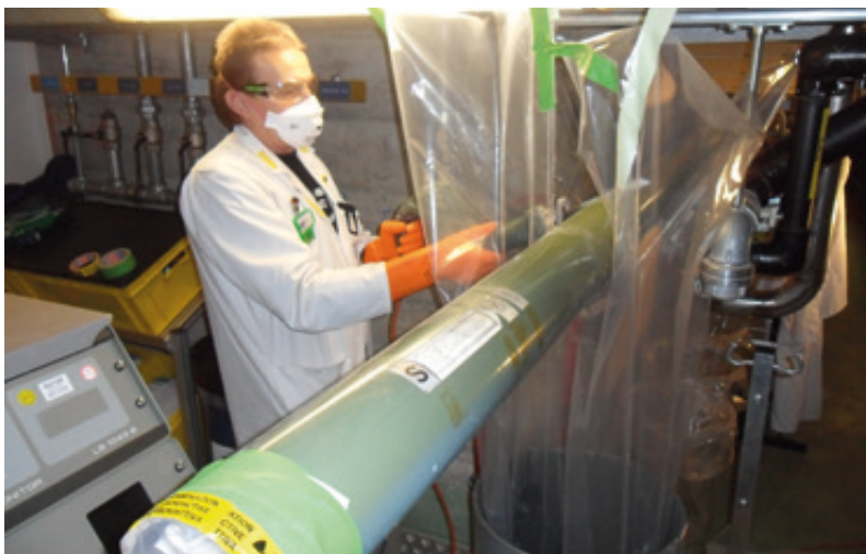
Abb. 2: Trennung einer Aktivabwasserleitung in einer „Wanderzone“
