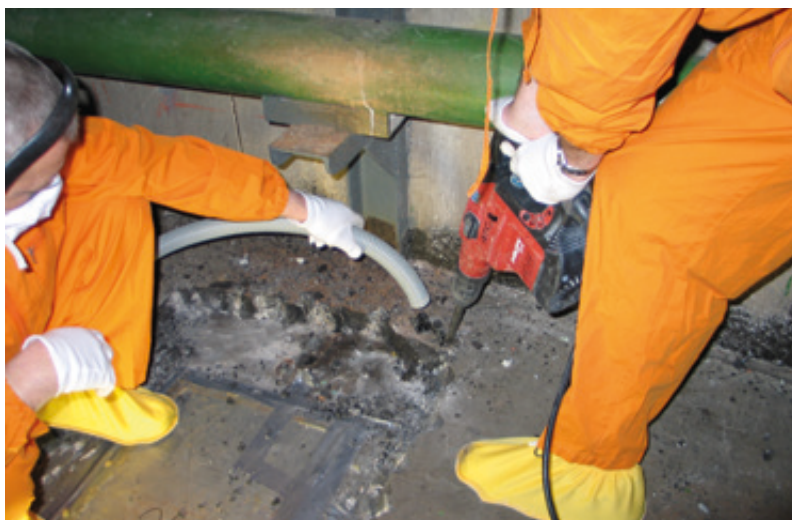
Abb. 3: Typische Situation im Rückbau: Stemmarbeiten an einer Betonstruktur zur Vorbereitung von Freigabemessungen
